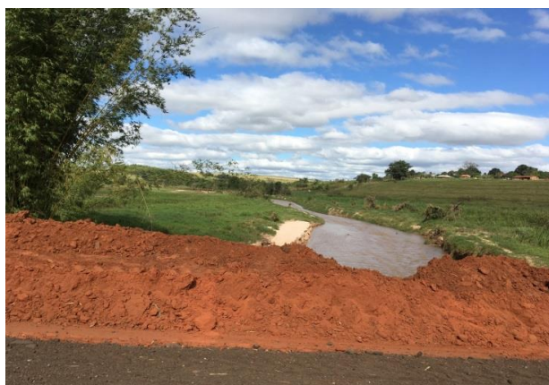
Foto 3.67 – Ponte destruída sobre o Rio Iacri
