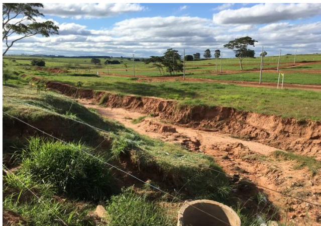
Foto 3.77 – Erosão na Rua João M. Guilherme próxima ao loteamento
