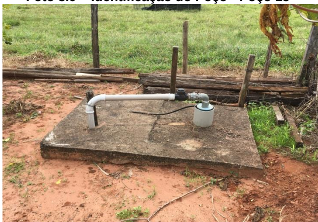
Foto 3.11 – Identificação do Poço - Poço 17
