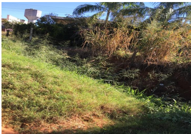
Foto 3.81 – Início da erosão
