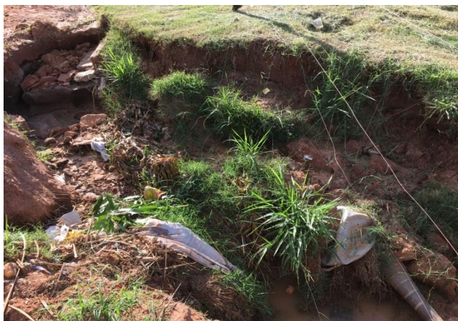
Foto 3.73 – Início da erosão na Rua João M. Guilherme
