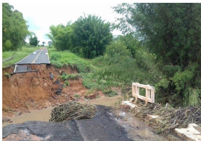
Foto 6.6 – Ponte destruída após intensa chuva em Jan/2017 – Fonte: www.tupanoticias.com.br
