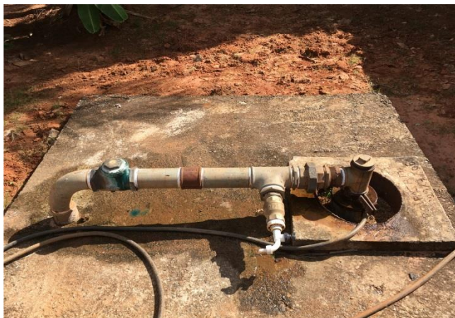
Foto 3.7 – Identificação do Poço - Poço 12
