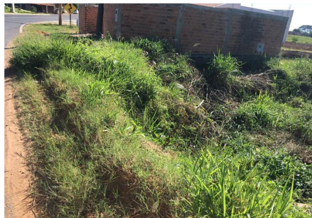
Foto 3.79 – Av. Brasil com erosão em 2017
