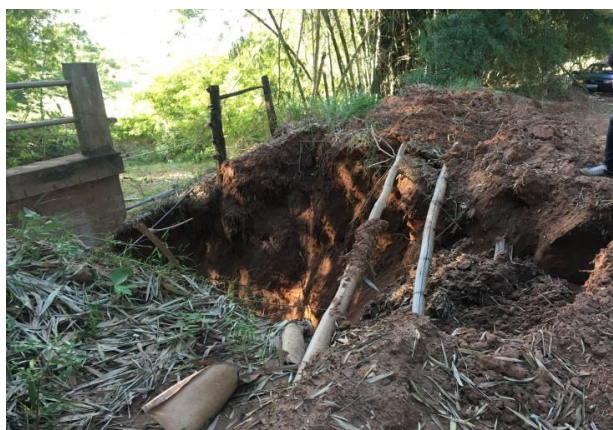
Foto 3.69 – Cabeceira destruída da ponte
