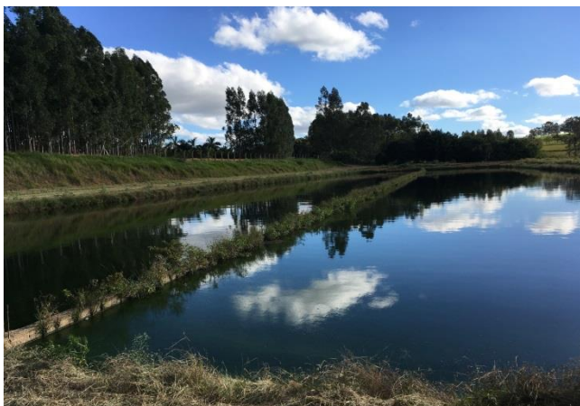
Foto 3.51 – Lagoa Facultativa – ETE 2
