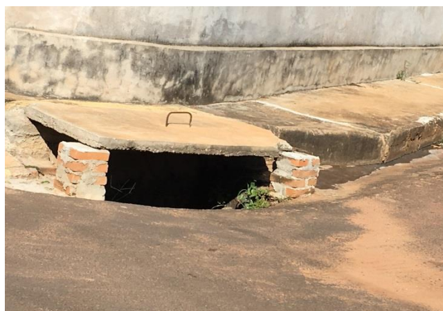
Foto 3.62 – Boca de lobo na esquina da Rua Luiz Garcia
