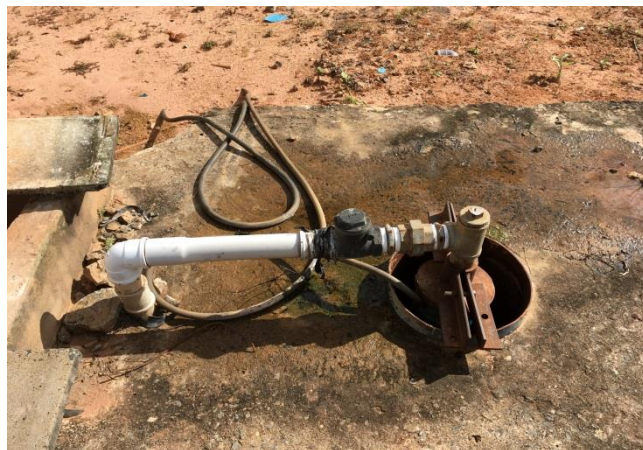
Foto 3.8 – Identificação do Poço - Poço 13
