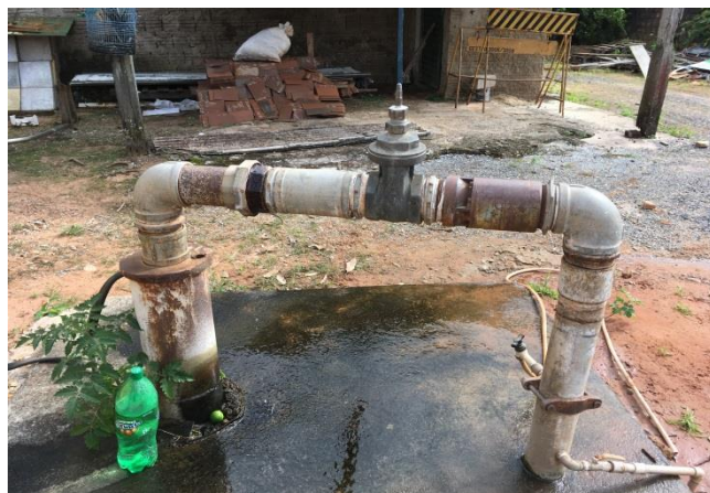
Foto 3.2 – Identificação do Poço - Poço 04
