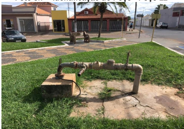
Foto 3.9 – Identificação do Poço - Poço 15
