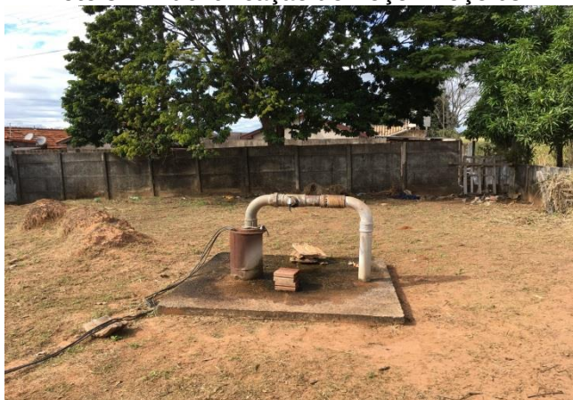
Foto 3.3 – Identificação do Poço - Poço 05
