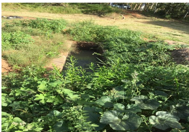
Foto 6.3 – Canal de tratamento preliminar sobrecarregado e sem manutenção na ETE 2
