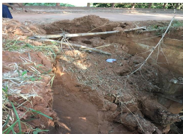
Foto 3.70 – Detalhe da ponte com a cabeceira quebrada
