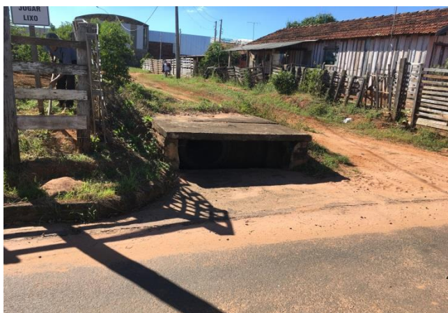
Foto 3.61 – Boca de lobo no cruzamento, diâmetro insuficiente
