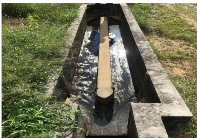
Foto 3.45 – Caixa de areia – ETE1
